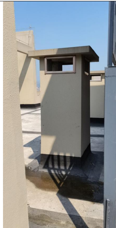
厨房油烟排放口
