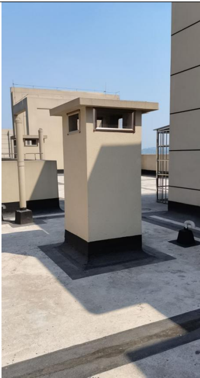
厨房油烟排放口
